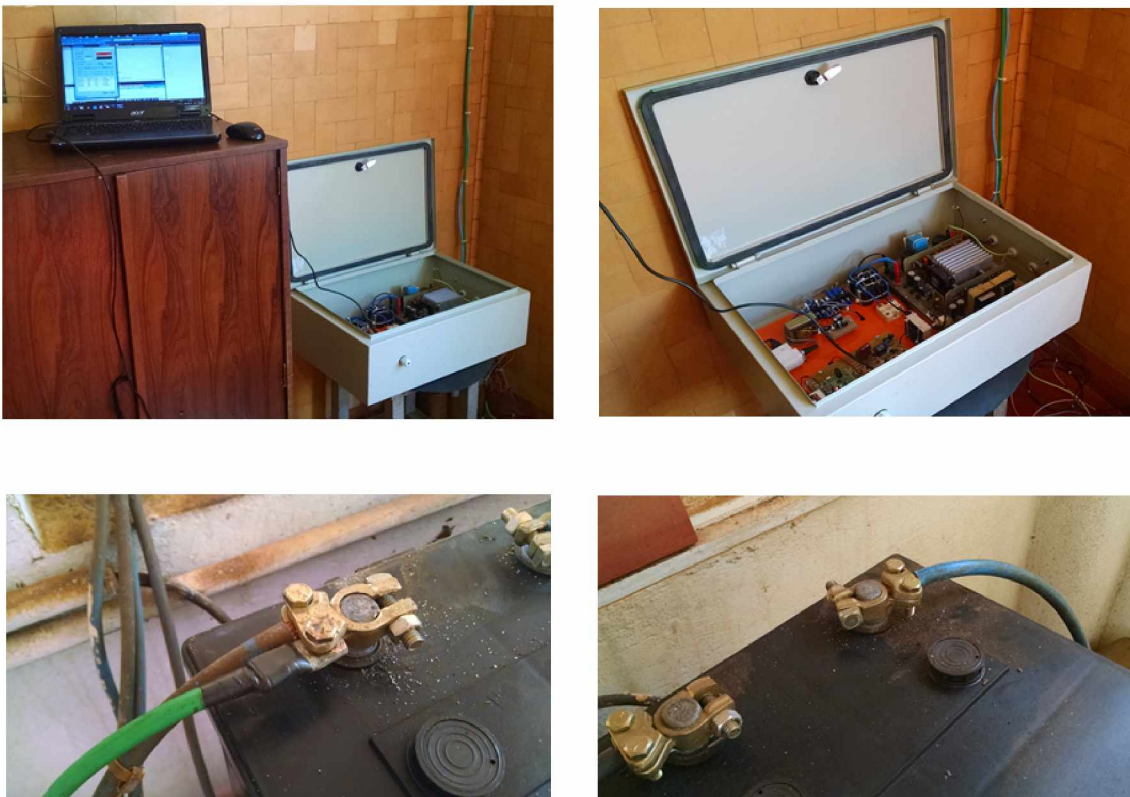
Figura 70 – Instalação do detector e localizador de faltas na PCH Martins.
