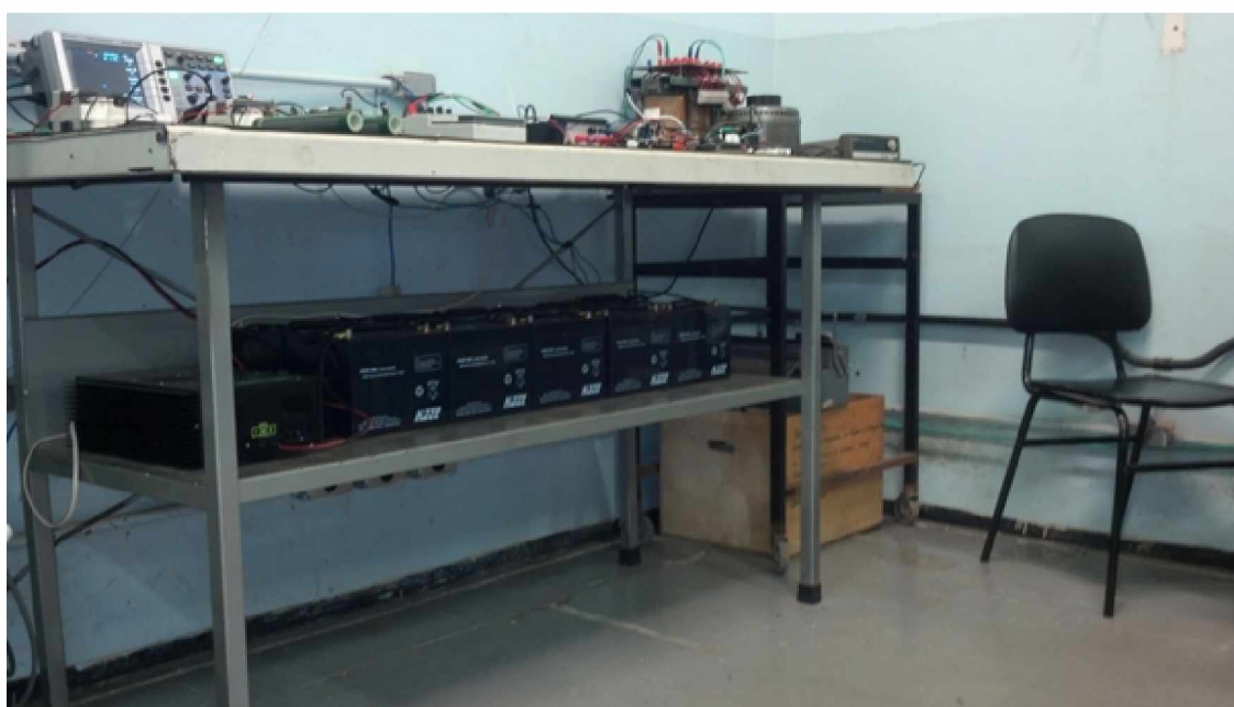
Figura 67 – Detalhe o banco de baterias da bancada de testes.
