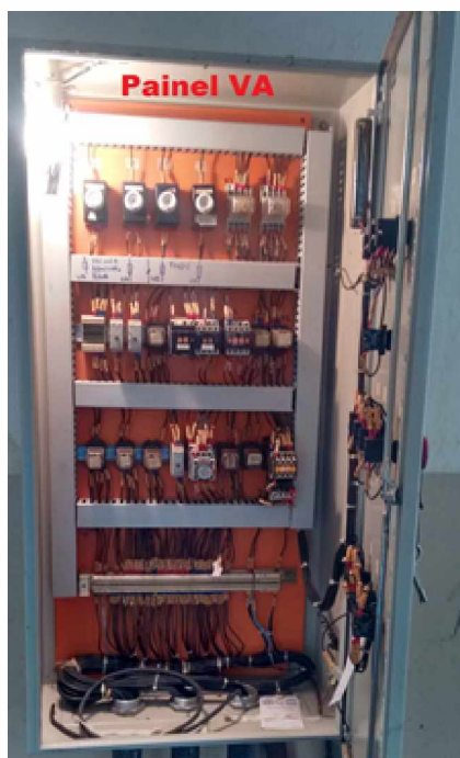
Figura 73 – Painel da UHE Pissarão onde os filtros sintonizados foram instalados.
