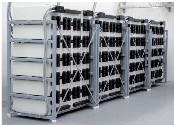
Figura 3 – Banco de baterias.
