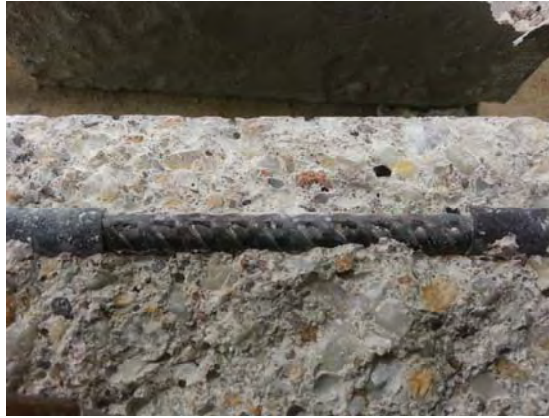
Figure 2.34 : Etat de surface des armatures après les essais de carbonatation accélérée (F4-6, F4-7 et F4-8).
