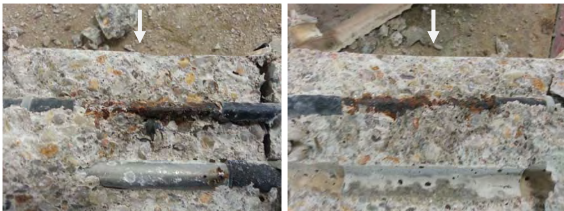
Figure E.D : État de surface des armatures après les essais de carbonatation accélérée en conditions hydriques cycliques (F4-23 et F4-24)
