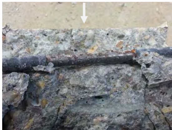
Figure G.C : État de surface des armatures après les essais d'aspersion d'ions chlorure (F3-11, F3-12 et F3-13)
