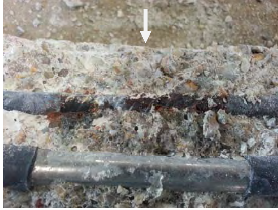
Figure H.D : État de surface des armatures après les essais de carbonatation accélérée couplés à la diffusion des ions chlorure par aspersion (F4-16, F4-17, F4-18)
