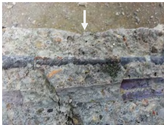
Figure H.B : État de surface des armatures après les essais de carbonatation accélérée couplés à la diffusion des ions chlorure par aspersion (F2-16, F2-17, F2-18)
