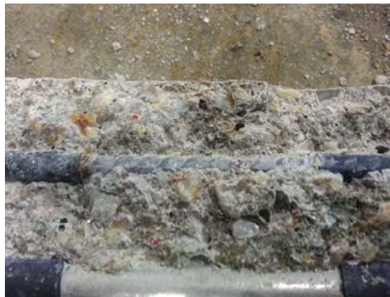
Figure F.A : État de surface des armatures après les essais de diffusion des ions chlorure par immersion (F1-1, F1-2 et F1-3)
