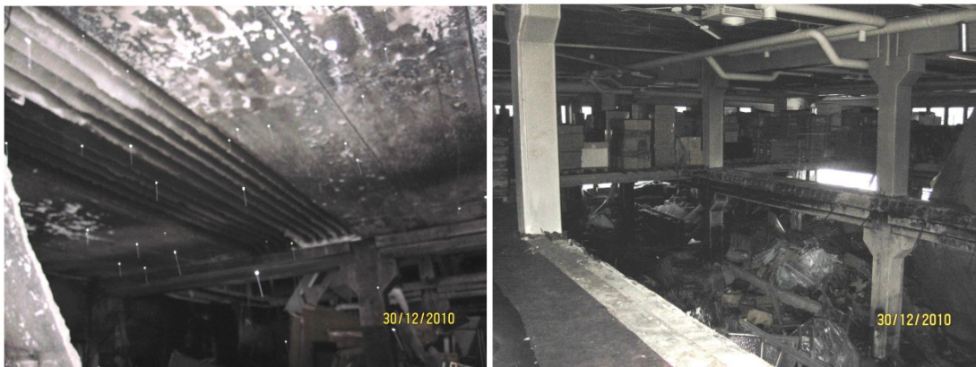
Figur 18 Skador på håldäck i Vantaa, Finland. Den vänstra bilden visar delaminering av den nedersta delen av ett håldäck, den högra bilden visar tomrummet efter kollapsen av håldäckssystemet (Lehtinun & Rasmus 2011).
