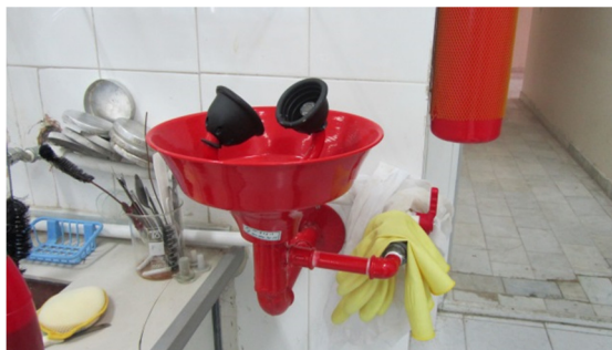
تصویر ۴- نصب چشم شوی در آزمایشگاه پس از استقرار ایمنی در آزمایشگاه‌ها
