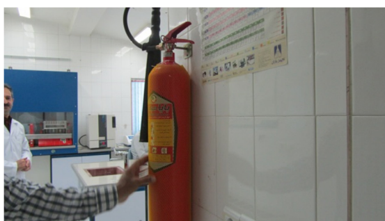
تصویر ۱۲- نصب کپسول های اطفاء حریق در آزمایشگاه ها (پس از استقرار ایمنی در آزمایشگاه ها)
