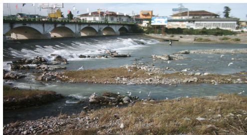
تصویر ۱- صید غیر مجاز و وضعیت پایه پل در رودخانه ها
