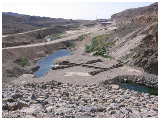
شکل ۶۵ - چاه های فشار شکن (ناشی از نشت آب زیر تاج سد)
