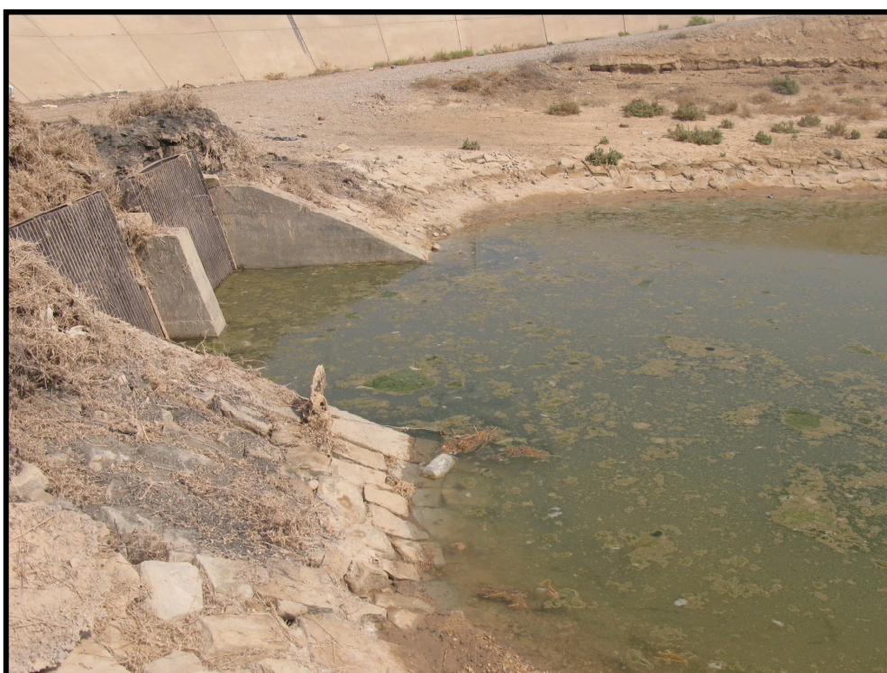
شکل ۲-۷- نمایی از ایستگاه ۶ پمپاژ (طرح شبکه آبیاری و زهکشی دشت شمال شرق اهواز)
