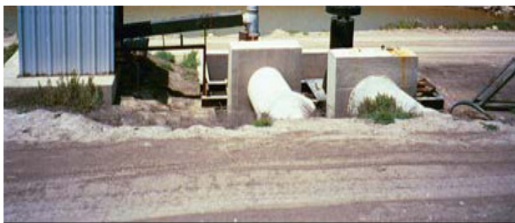
پمپ جهت برگشت آب به کانال آب چرخشی (مکزیك)
