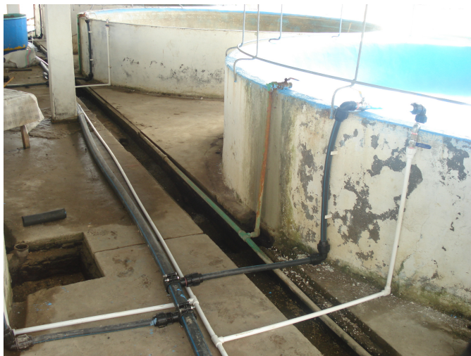
تصویر ۱۲: راه اندازی سیستم ورودی آب دریا به حوضچه های پرورشی
