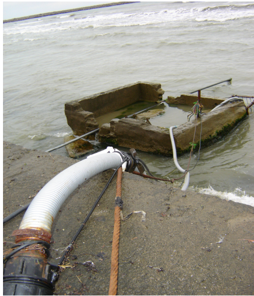
تصویر ۳: پمپاژ آب دریا به حوضچه های رسوبگیر
