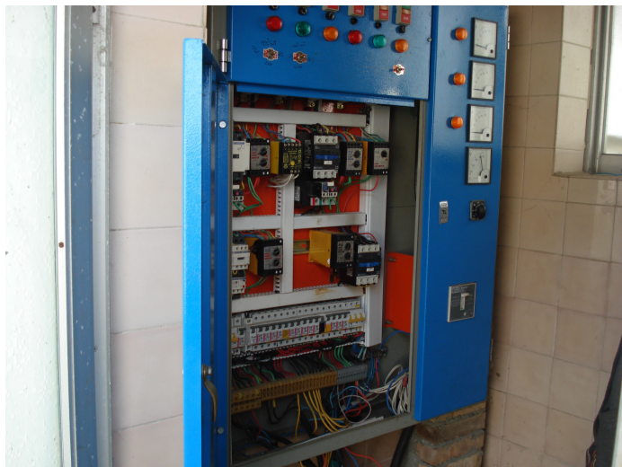
تصویر ۸: راه اندازی جعبه کنترل برای تنظیم سطح آب منبع
