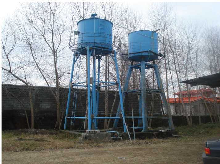
تصویر ۹: منبع آب جهت انتقال آب بصورت ثقلی به حوضچه ها ( در داخل منبع آب سنسور جهت کنترل سطح آب منبع کار گذاشته شده است)
