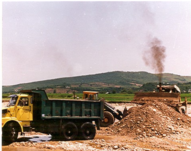
شکل ۲۵. برای بهره برداری شن و ماسه بستر رودخانه تخریب می شود ( کارگاه شن و ماسه سنگتراشان )
