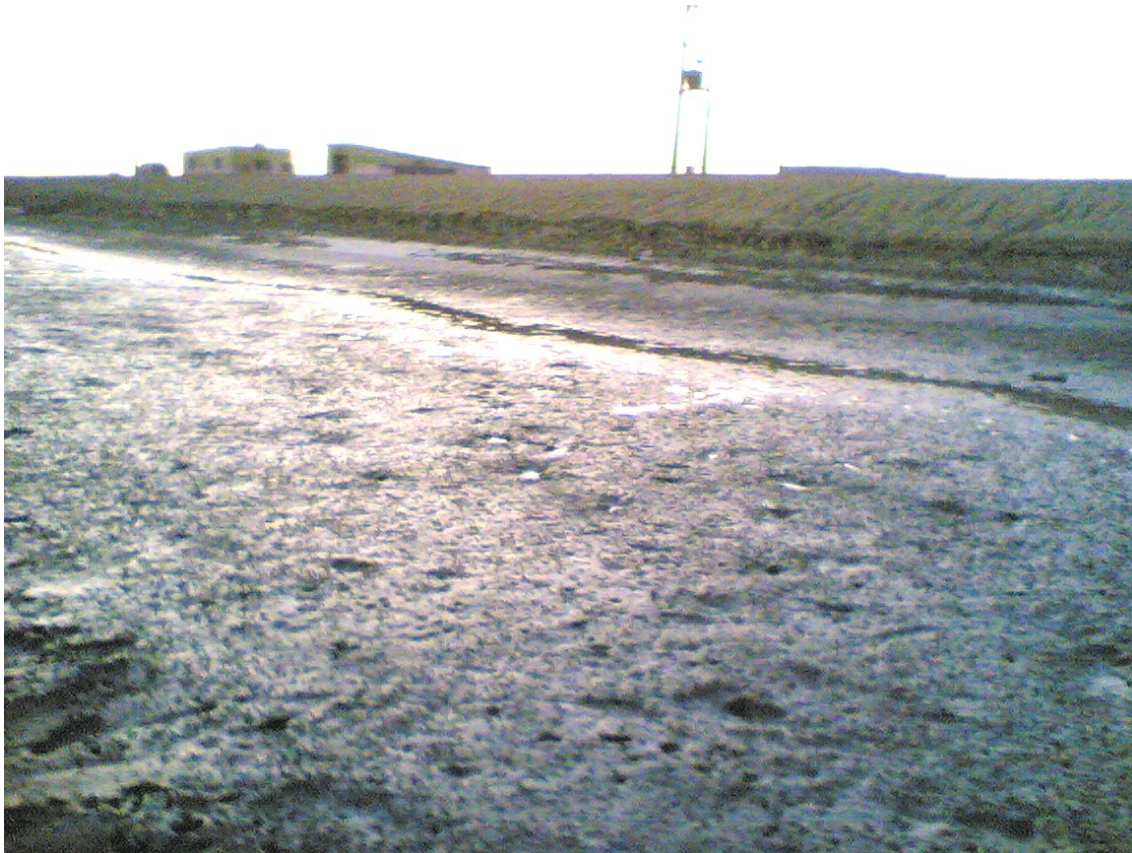
شکل ۱۸: تخریب دیواره کانالها و خالی بودن انتهای کانال از آب و عدم امکان آبیگری مناسب برای
