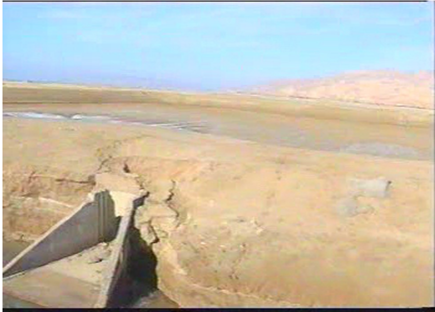
شکل ۲۳: تخریب و ایجاد سوراخ در کنار دریچه خروجی استخرها در بعضی مزارع مستقر در منطقه سایه خوش
