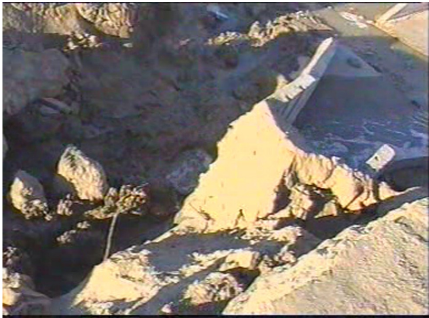
شکل ۲۴: تخریب کامل دریچه خروجی استخرها در بعضی مزارع مستقر در منطقه سایه خوش
