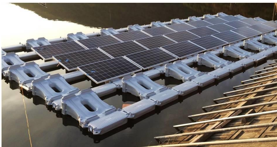
Figura 41 - Estrutura de suporte dos módulos instalados na central B
