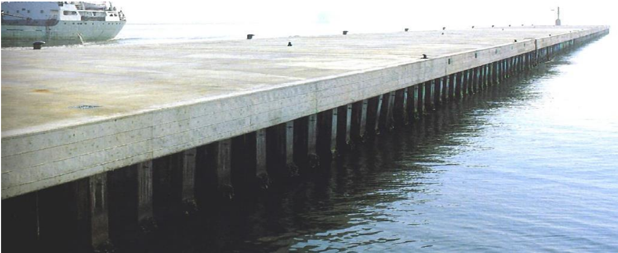
Figura 3.15 - Cais fundado em estacas com viga de coroamento em betão armado (Veloso Gomes)
