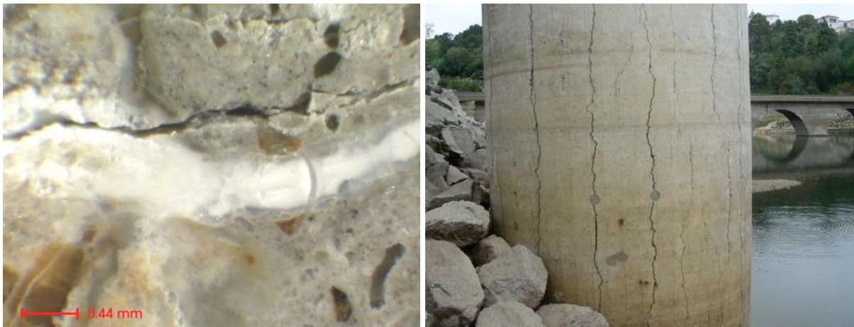
Figura 2.15 - a) Exemplo do gel formado na reação álcali-silica; b) Exemplo de fendilhação causada por este ataque (Costa, 1997)
