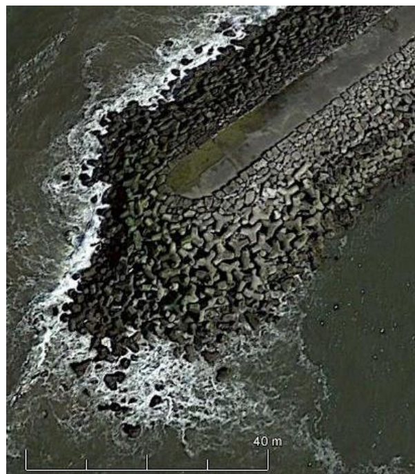
Figura 5.5 - Cabeça do talude parcialmente destruída à data de 2013 (Veloso Gomes)
