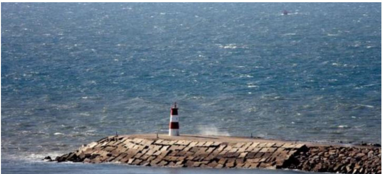
Figura 3.29 - Molhe norte de Aveiro construído em blocos de betão maciços do tipo antifer (Irmãos Cavaco)
