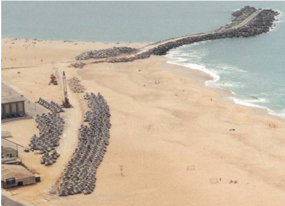
Figura 5.2 - Vista aérea do esporão com a cabeça parcialmente destruída e os tetrápodes prontos a serem depositados (Velooso Gomes)
