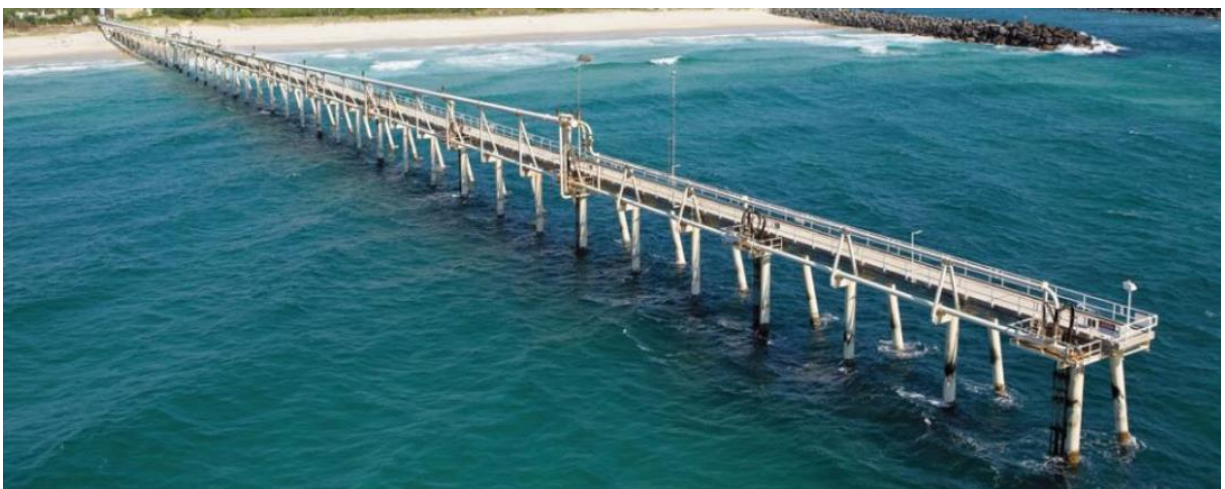
Figura 3.33 - Sistema bypass com bombas assentes nos pilares de uma estrutura de betão na Austrália ( www.insidegoldcoast.com )
