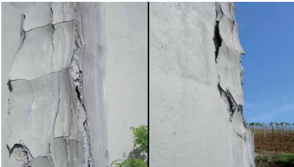
Figura 2.12 - Exemplo de reação expansiva por ataque de sulfato (Mapei, 2014)
