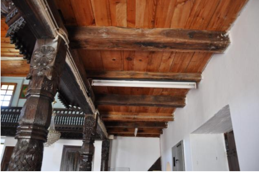
Şekil 9. Harimde Ahşap Dikmeler
