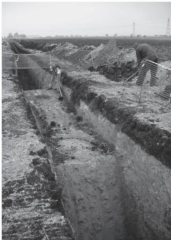
Fig. 2 Monte da Barrada II antes da escavação. Área a intervir enquadrada com a vala do futuro sistema de rega.
