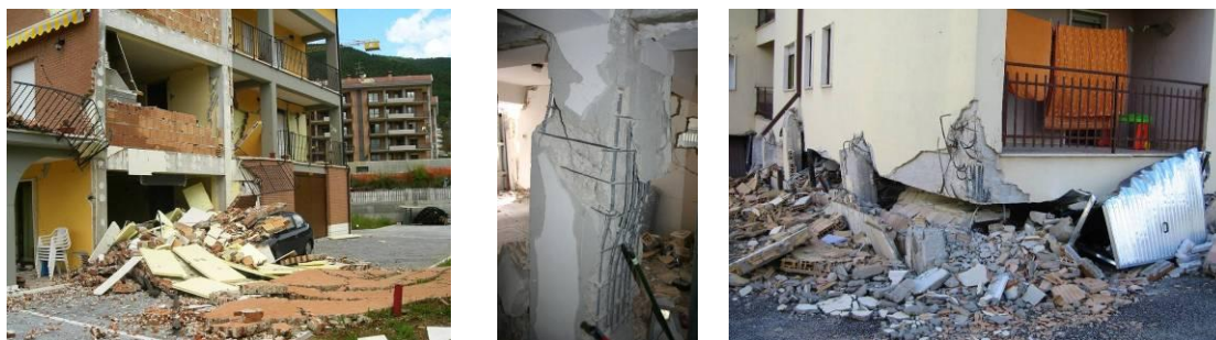
Figura 3: Danos em estruturas de betão armado
