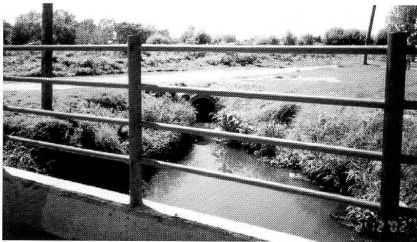
Arroyo Maldonado. Puentes de mayor sección que los conductos aguas abajo.
