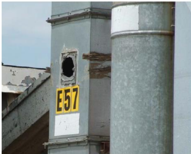
Fig. 3: emissione dotata di punto di campionamento privo di bocchello: bocchello distaccato dalle pareti del camino.
