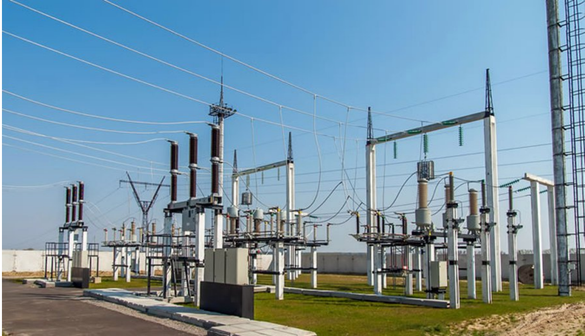
Figura 3-7. Subestación eléctrica de la compañía Krostec, México.
