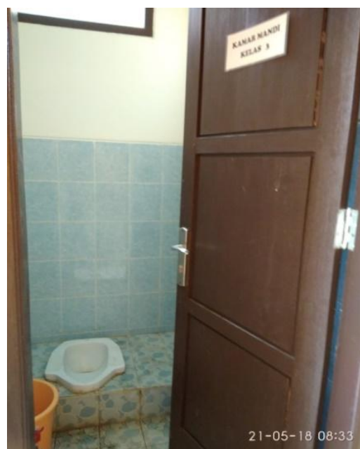
Gambar.3.7. Kondisi di dalam Toilet Sekolah NT
