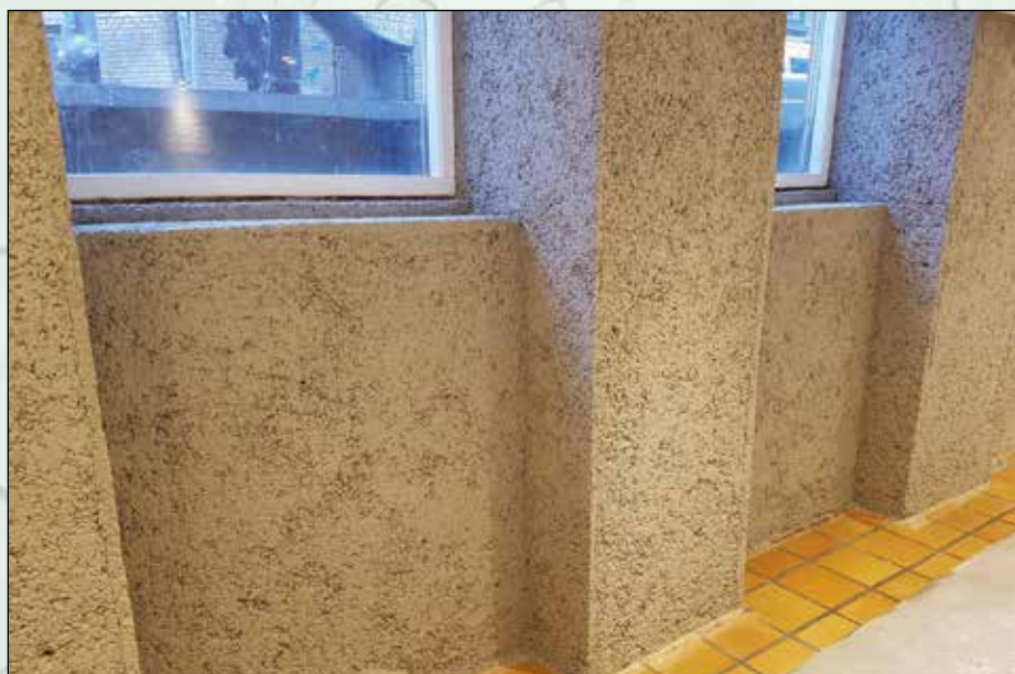
En næsten færdig kældervæg, hvor fugten kan transportere sig igennem, og murværket kan ånde.
