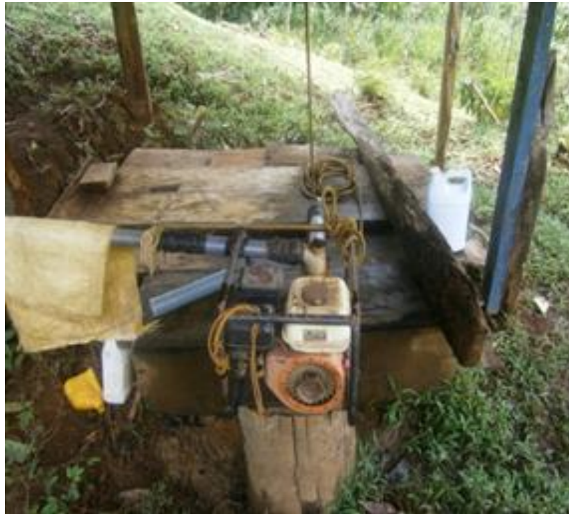
Figura 8. Sistema de bombeo con combustible.
