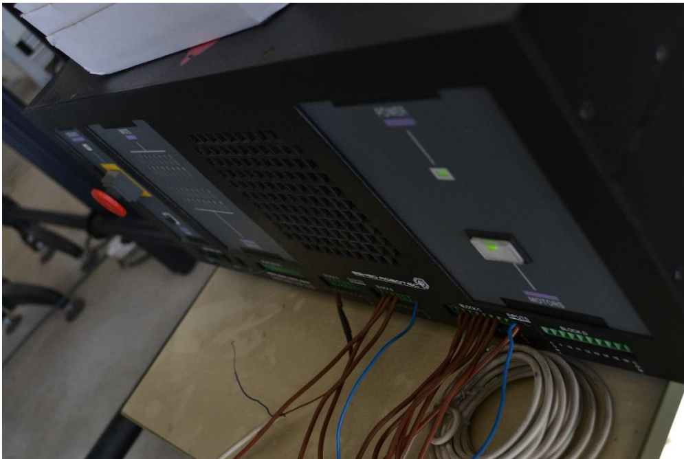
Figura 5.13. Cableado del controlador del brazo robótico
