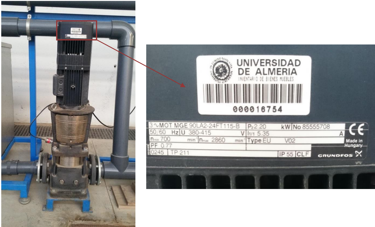
Figura 2-3 Bomba hidráulica de eje vertical del banco de ensayo
