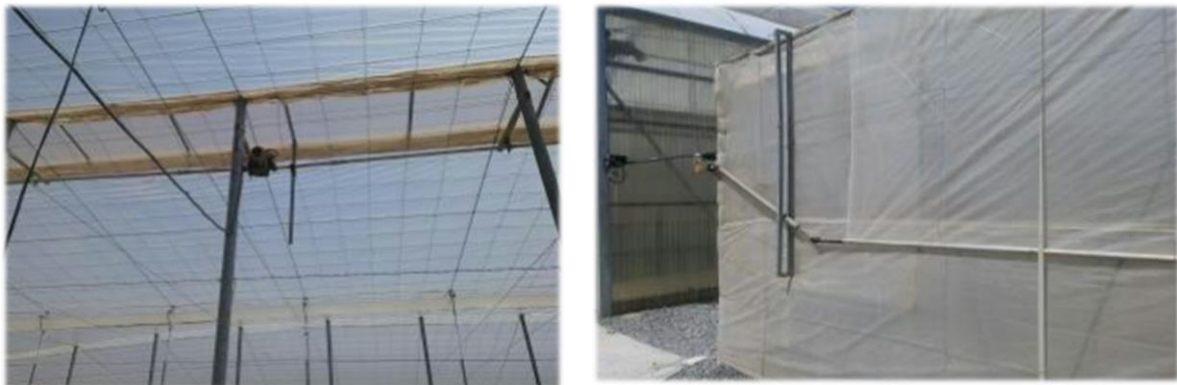
Figura 3. Detalle del sistema de ventilación del invernadero U14, a la izquierda podemos observar las ventanas cenitales, a la izquierda un detalle de las ventanas laterales, ambas presentan una apertura y cierre automatizado.
