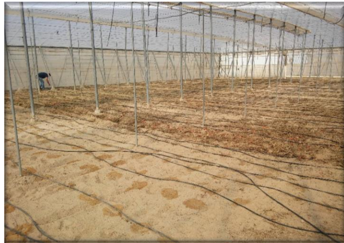
Figura 9. Verificación de los emisores de riego, en la imagen se observa una mayor densidad de ramales porta-goteros para una mayor eficiencia en el proceso de descomposición de la materia orgánica..
