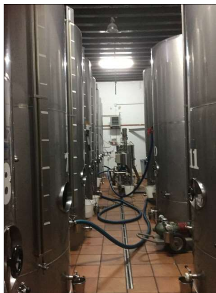
Fig. 5: Nave lateral. Antiguo lagar hoy depósitos de acero inoxidable. Foto Propia
