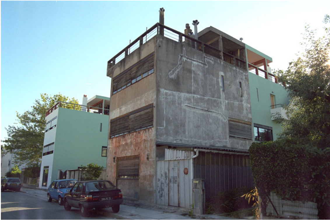
Fig. 4 - Le Maison gratte-ciel del quartiere Pessac vicino Bordeaux durante il ripristino degli anni Novanta volto a rinnovare l'aspetto delle case che, tornate di moda, sono divenute oggetto del mercato immobiliare, non di una riconsiderazione storico-critica (foto dell'autore).
