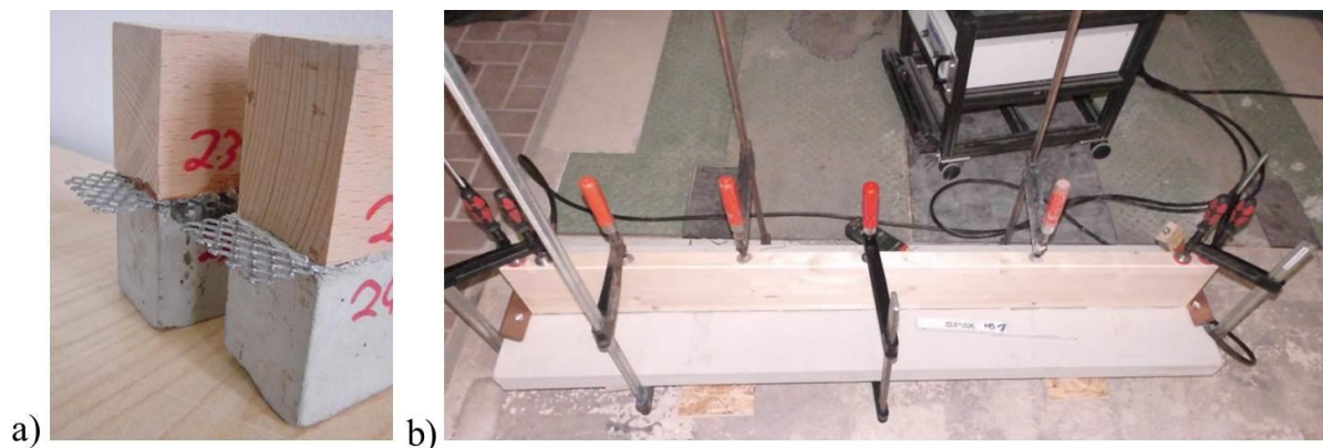
Abb. 5: HBV mit elektrischer Widerstandsbeheizung im Klebeband: a) Buchen-HBV mit 15 mm herausstehenden Enden des Streckmetalls, b) Klebversuche an mittelgroßen T-Trägern (Kleblänge 1700 mm) Versuchsaufbau inkl. Anschluss an Baustellen-Stromquelle
