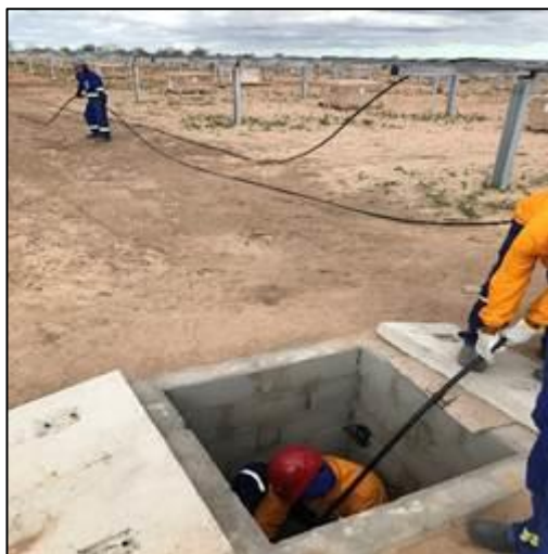
Figura 2.14 - Instalação dos cabos condutores nos eletrodutos em vala escavada pelo método convencional
