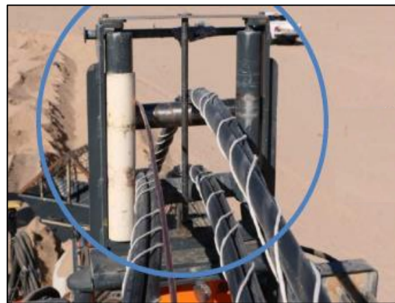
Figura 2.21 - Detalhe da separação dos cabos (organização dos cabos antes de chegarem à caixa de lançamento)
