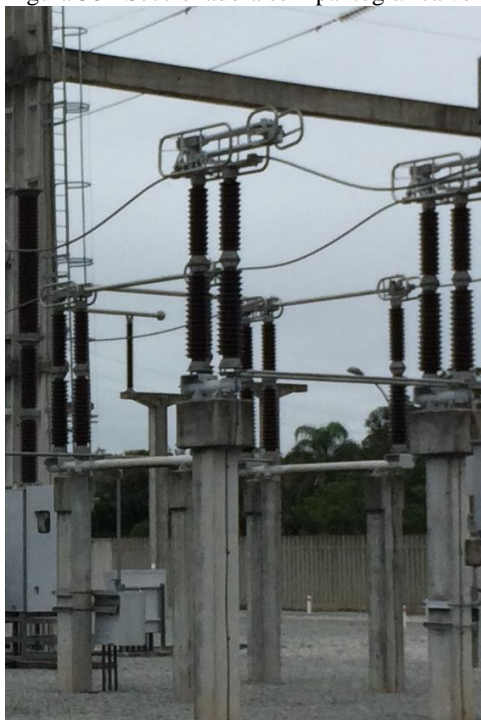
Figura 38 - Seccionadora semipantográfica vertical
