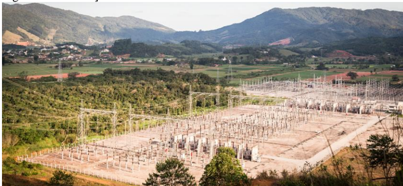
Figura 2 - Subestação externa ou a céu aberto
