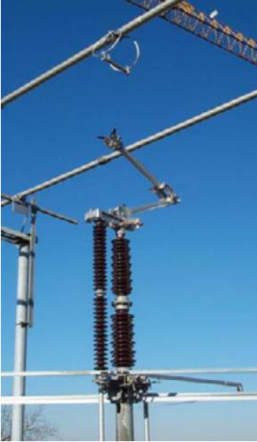
Figura 24 - Seccionadora de abertura semipantográfica vertical
