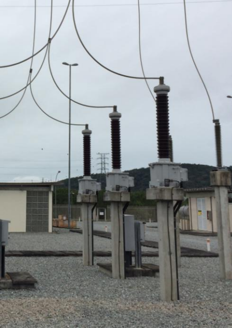
Figura 40 - Transformador de potencial capacitivo
