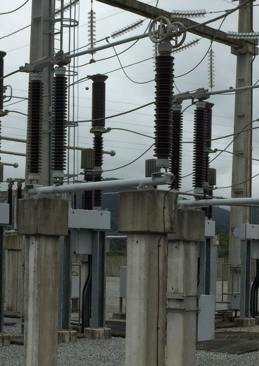
Figura 37 - Seccionadora de abertura vertical
