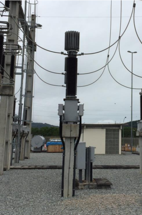
Figura 39 - Transformador de corrente
