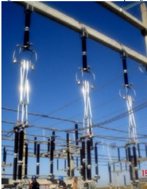
Figura 25 - Seccionadora de abertura semipantográfica
