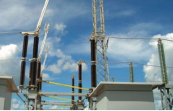
Figura 21 - Seccionadora de abertura vertical
