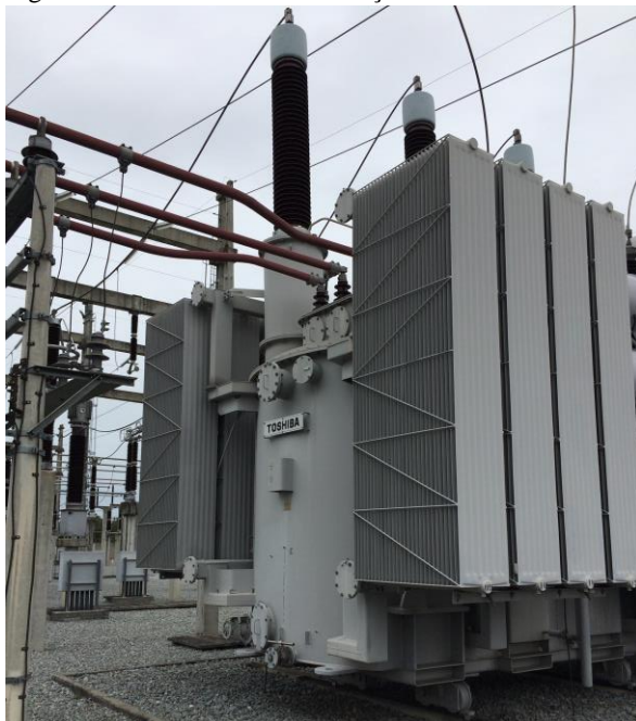
Figura 35 - Transformador de força
