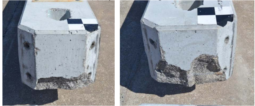
(d) Barriers 6 and 7 Damage
