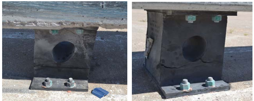
(d) Post Damage
