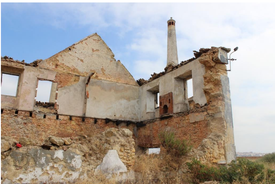
Registo Fotográfico. Imagens da autora – Estado atual do edifício onde se localizava a Quinta de Recreio
