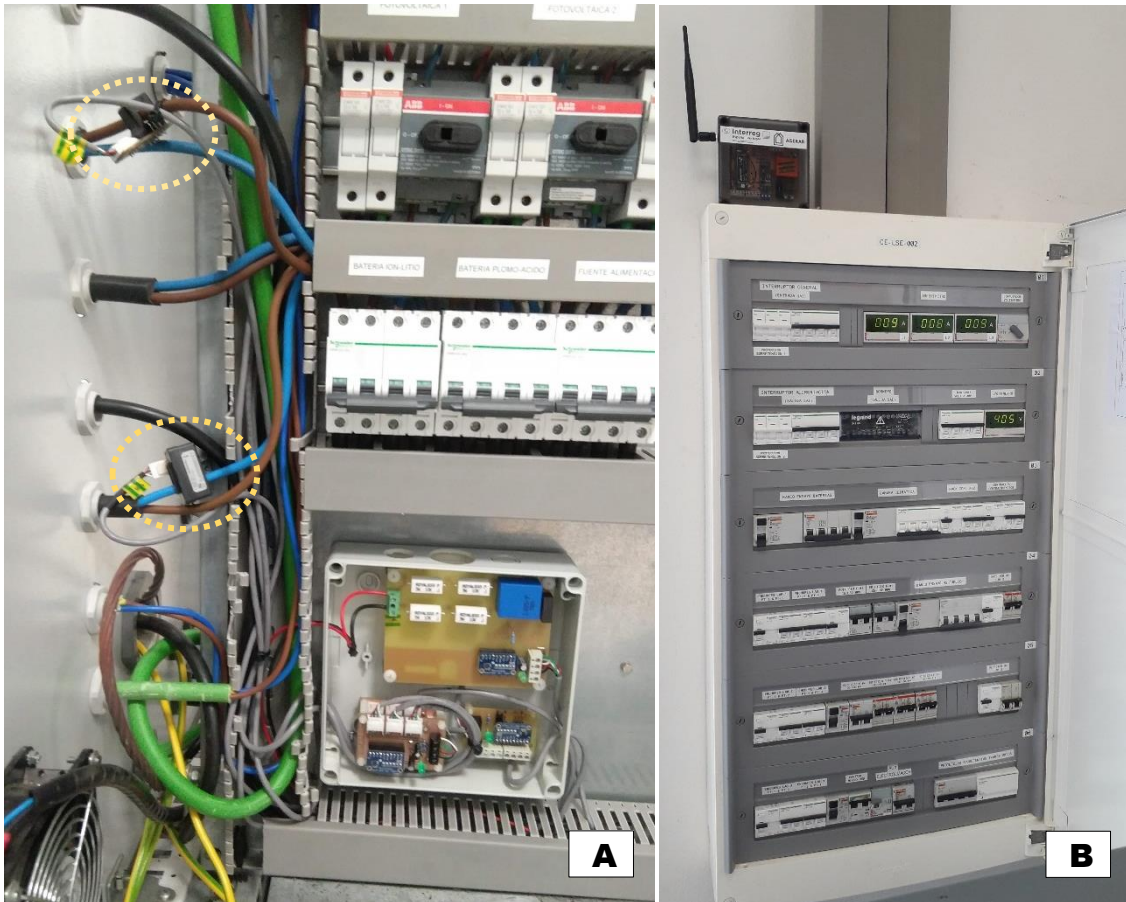
Figura 5.12 - Pormenor da instalação na micro rede INTA. Transdutores de corrente a tracejado amarelo e caixa com todos os conversores ADC (A). Módulo emissor Lopy Power Board, por cima do quadro elétrico, para conectar via Modbus a medidores de energia no interior do quadro elétrico (B)
