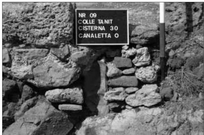
Fig. 297 - La canaletta di adduzione conservata in verticale ammassata al muro della cisterna 30 (foto dell'autore).
