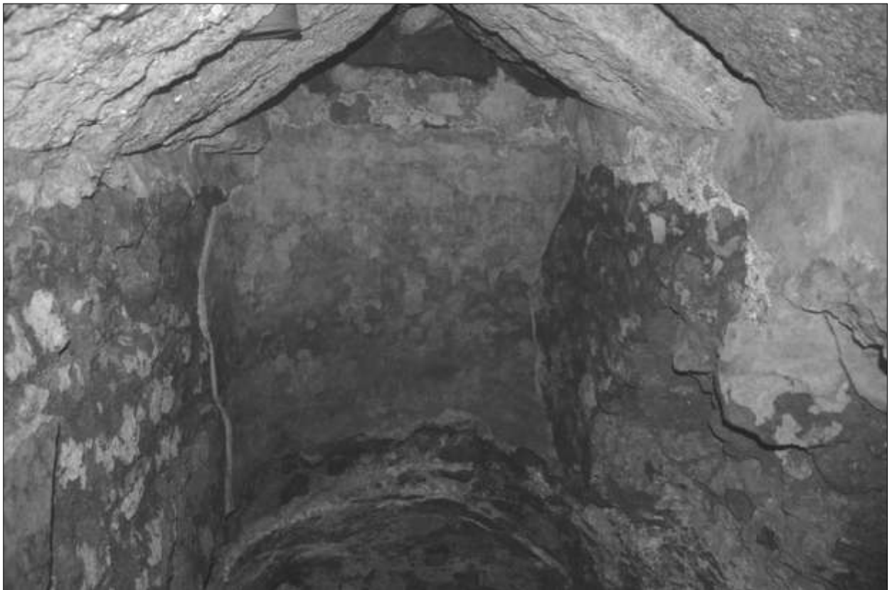
Fig. 169 - La cisterna 37 dall'interno, con la copertura a doppio spiovente e la canaletta centrale verticale (foto dell'autore).
