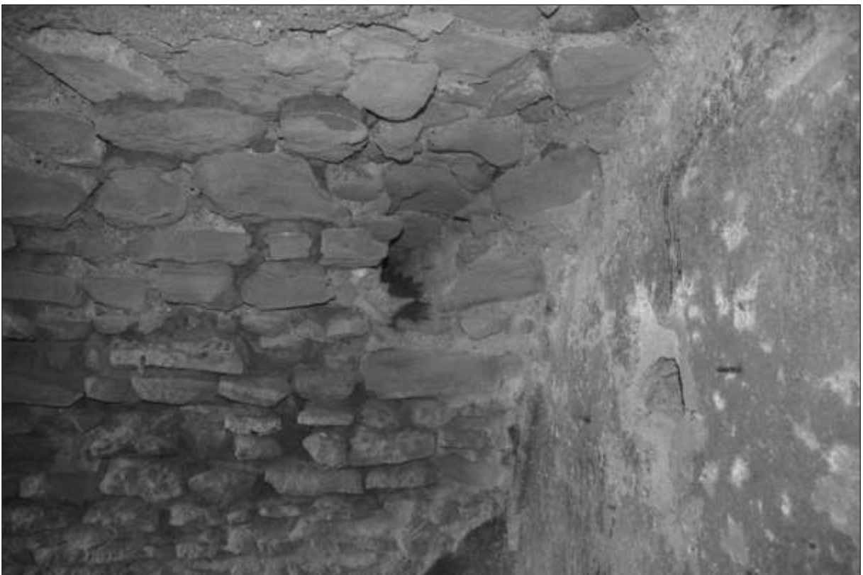
Fig. 195 - Particolare della canaletta di adduzione ricavata nell'angolo alto meridionale della cisterna/serbatoio 46 (foto dell'autore).
