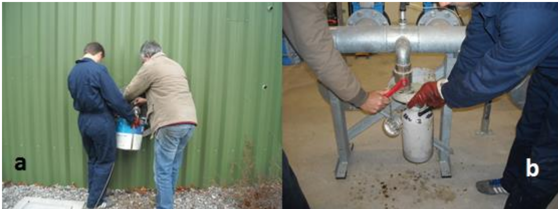
Figura 3.3-4 – campionamento presso impianti di biogas: tramite la valvola di ispezione montata direttamente sul digestore (a) o su tubazione in sala pompe (b)
