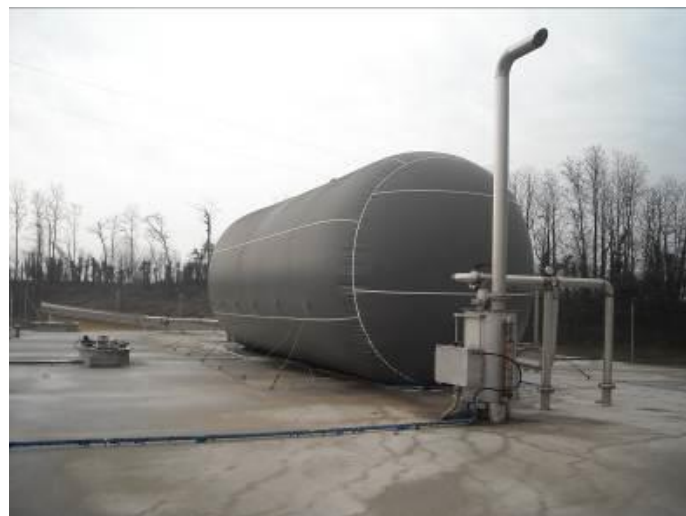
Figura 2.2-3 Gasometro per lo stoccaggio del biogas
