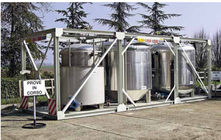
Foto 1 - Due digestori da 5 m 3 a campana gasometrica da 1 m 3 per l'accumulo del biogas
