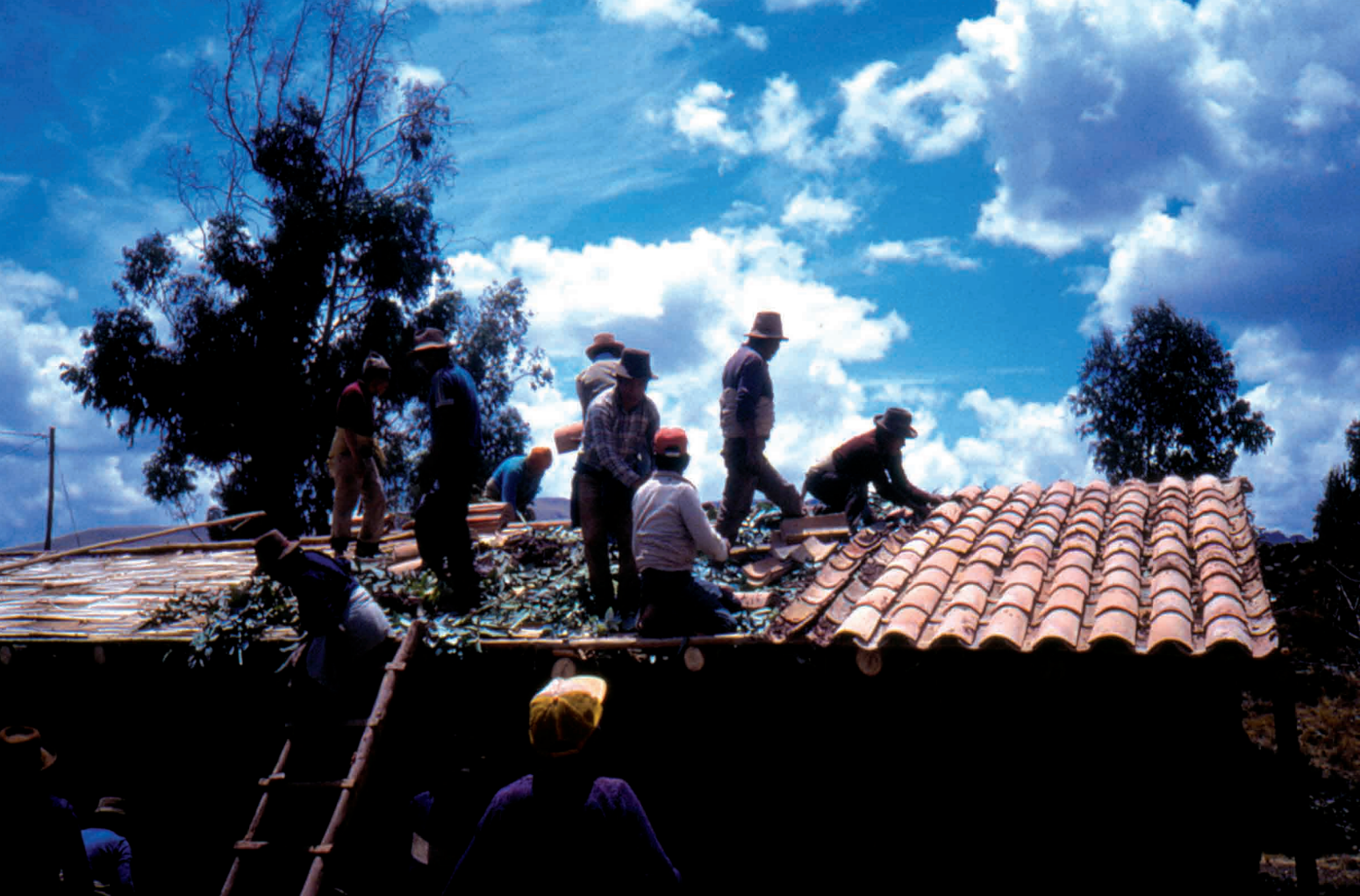
Hommes travaillant ensemble selon le principe de l'échange de travail, pour couvrir le toit d'une maison, juillet (Raqchi, Cuzco, Pérou)
