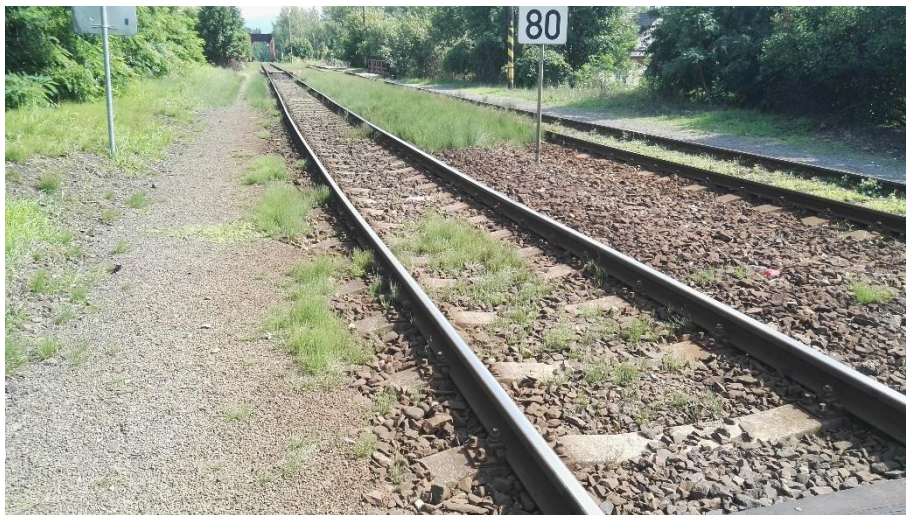
Obrázek 2: Znečištěné kolejové lože u žst. Frýdek-Místek (zdroj: autor)
