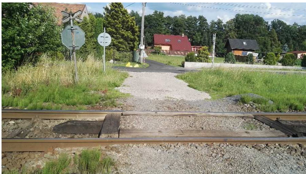
Obr. 10: Nezpevněná konstrukce stávajícího přejezdu (zdroj: autor)
