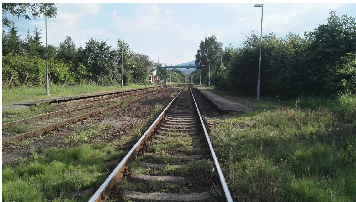
Obr. 5: Znečištěné kolejové lože v blízkosti žst. Pržno (zdroj: autor)
