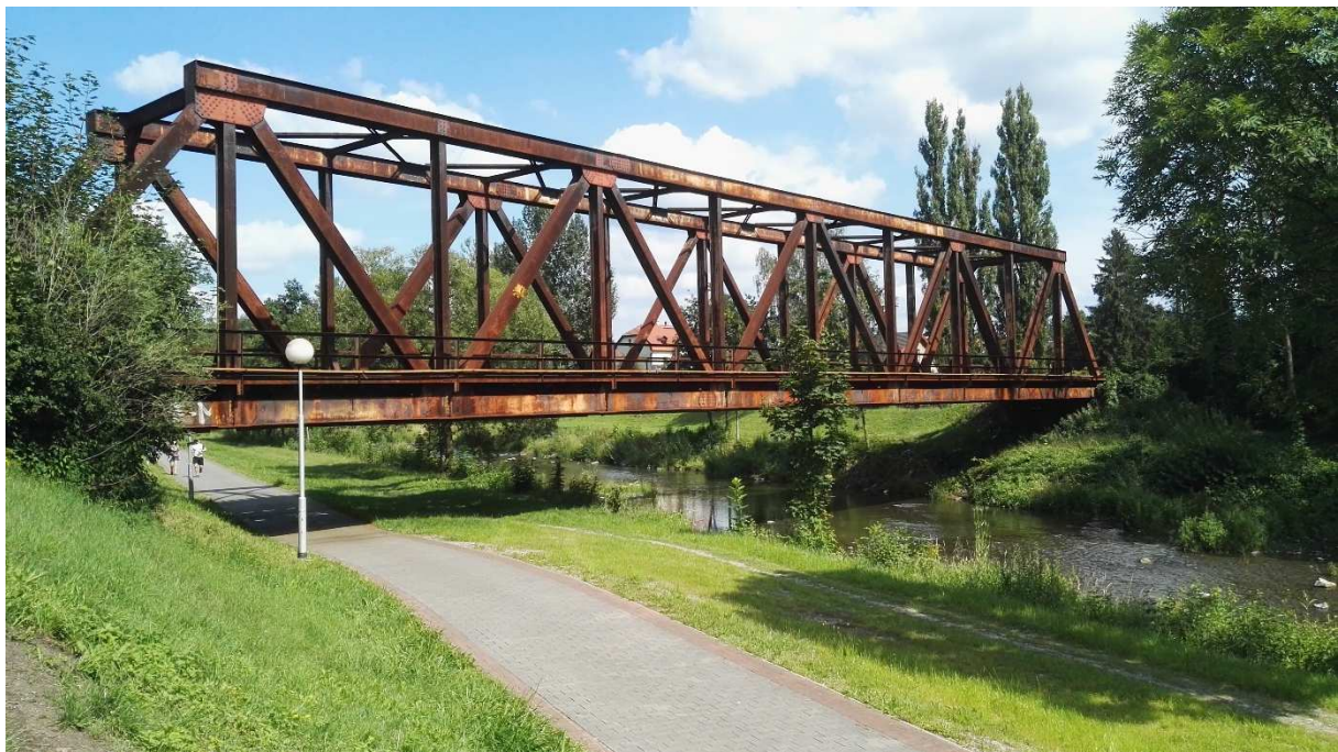
Obr. 8: Most v km 110,840 před rekonstrukcí (zdroj: autor)
