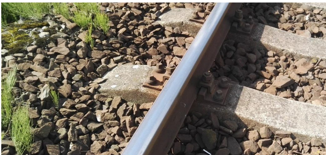
Obrázek 7: Nadměrné ojetí kolejnice a upevnění (zdroj: autor)
