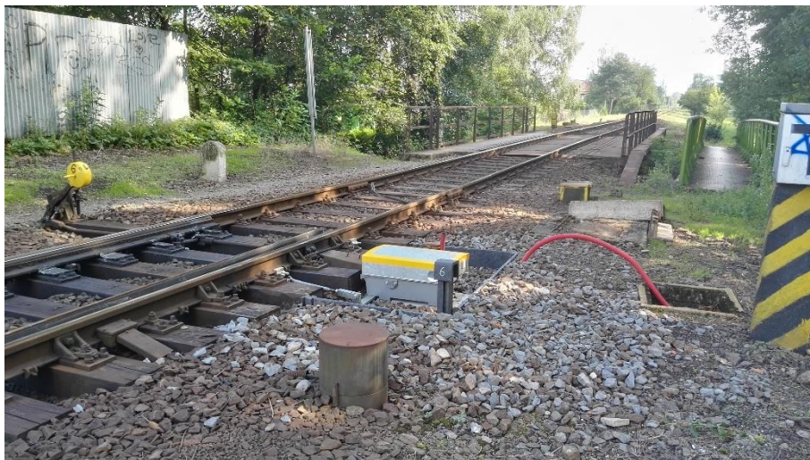
Obrázek 11: Přestavník výhybky v žst. Baška (zdroj: autor)
