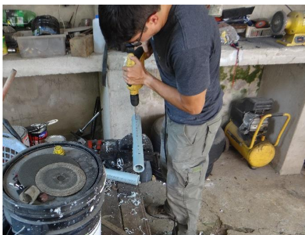
Figura 24a. Perfuração do tubo da entrada da água
