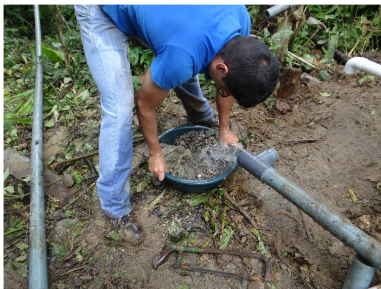
Figura 27. Lavagem dos matérias filtrantes.
