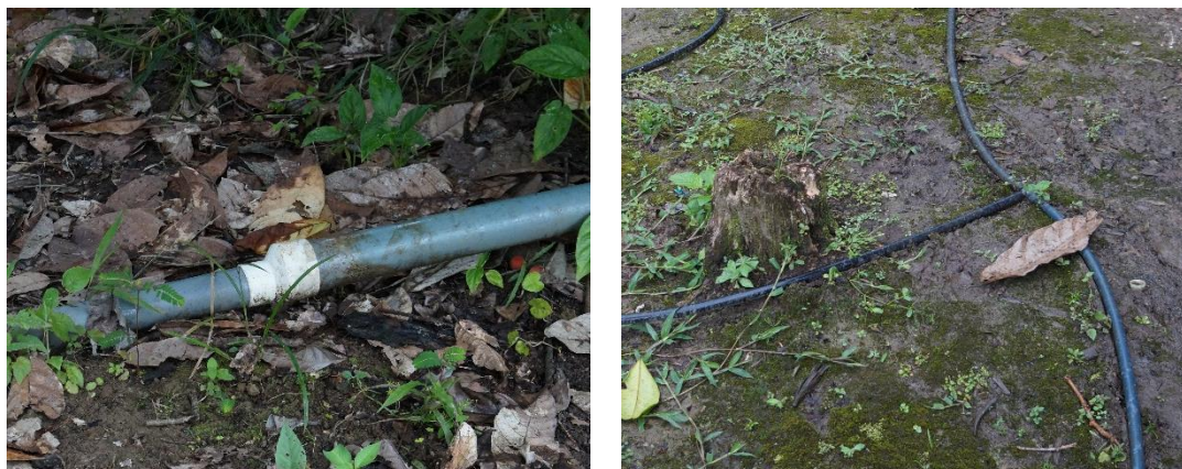
Figura 9. Redução da tubulação de 2,5" para 2,0", e sistema de distribuição da rede domiciliar é de 1/2".
