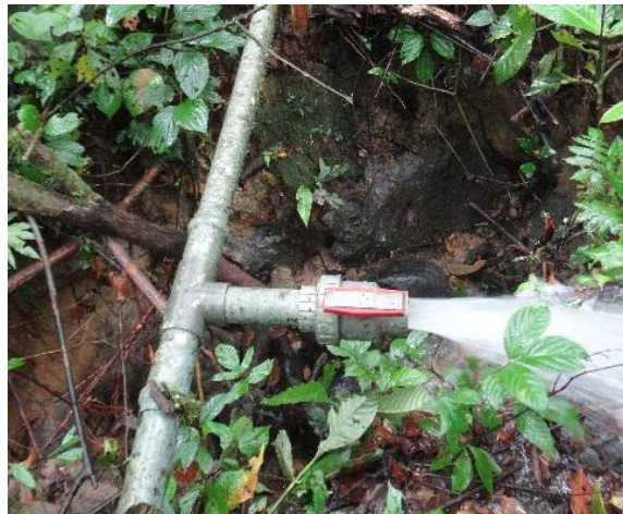
Figura 29b. Abertura das válvulas de purga do sistema de condução e abastecimento.
