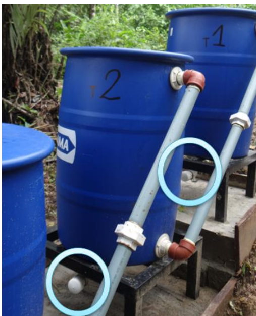
Figura 31. Válvula de limpeza dos filtros
