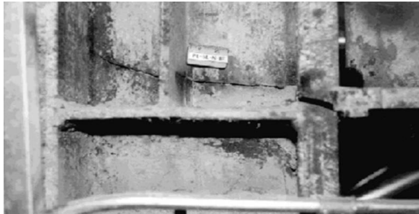
Figura 6. Propagación de la fractura del patín de la columna hacia el alma de la misma. Tomado de http://degenkolb.com/practice_areas/seismic_ordinances/pre_northridge_steel_moment_frame_buildings/
