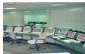
Central de Control y Operación
