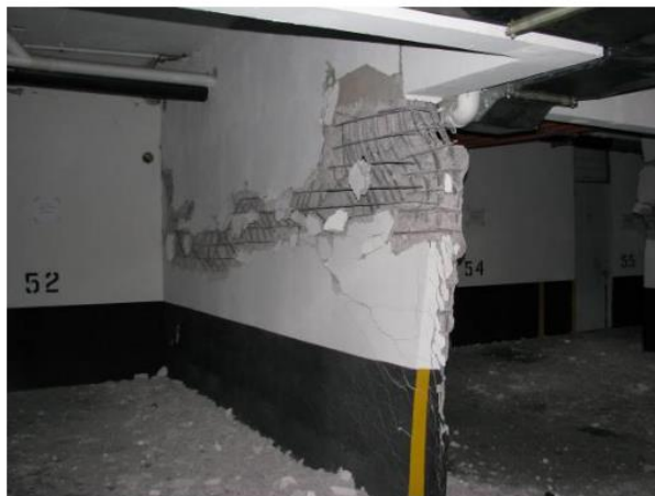
Figura 16: Pandeo fuera de plano de muro de hormigón armado (Torres Parra 2017)
