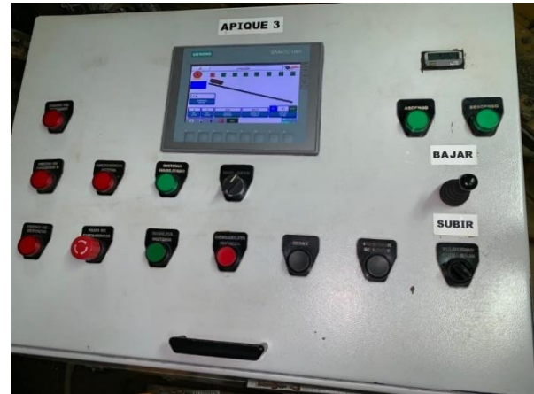
b) Actuadores de la consola de control
