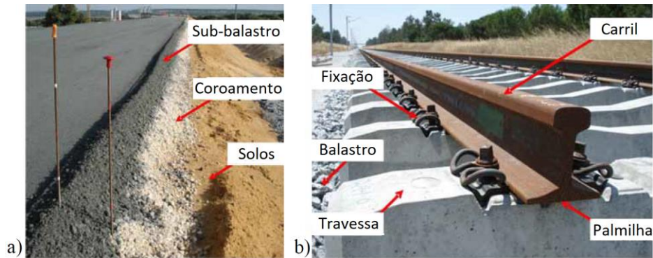
Figura 5.3 - Aspectos do pavimento durante a construção: a) camadas da subestrutura; b) componentes da superestrutura (adaptado de Paixão, 2014).
