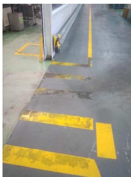
Figura 3.5 – Marcação com falta de manutenção
