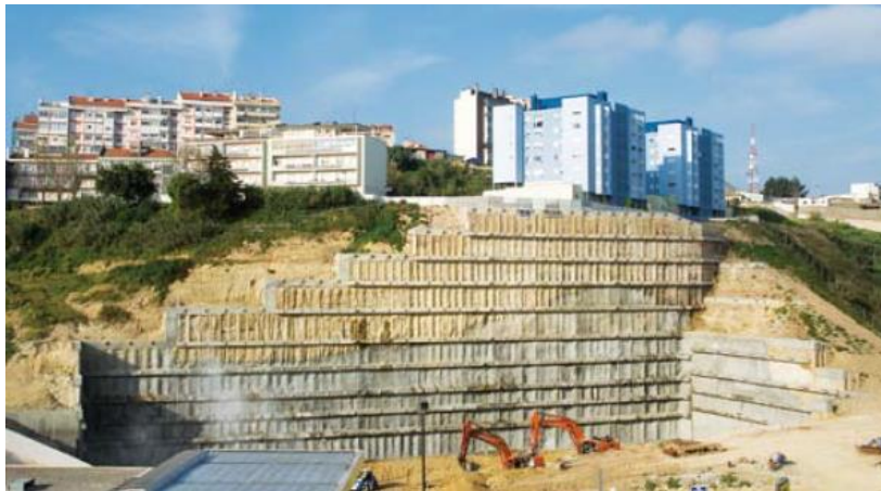
Figura 18 - Aplicação de cortina de estacas na biblioteca e arquivo municipal de Lisboa (Pinto & Pereira, 2007)
