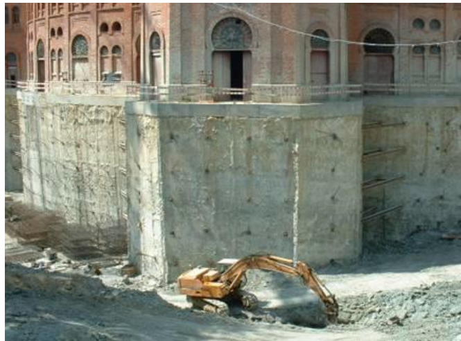
Figura 8 - Aplicação de paredes moldadas na envolvente da Praça de Touros do Campo Pequeno (Cortez, 2010)
