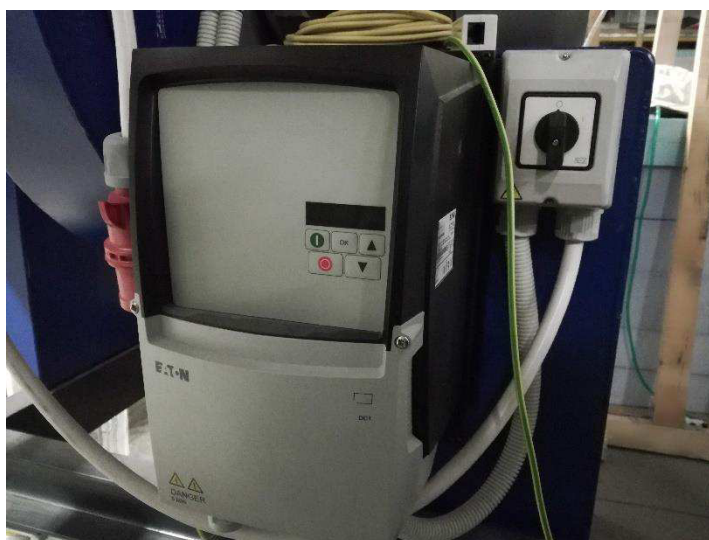
Obr. č.1: Frekvenční měnič a spínač ventilátoru
