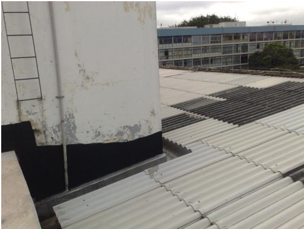
Figura 2. Imagem da atual queda de telhas de amianto.
