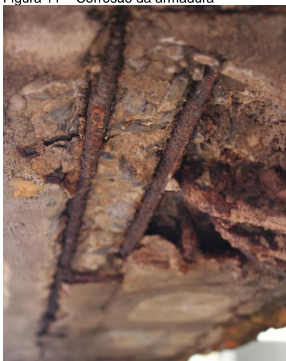
Figura 11 – Corrosão da armadura
