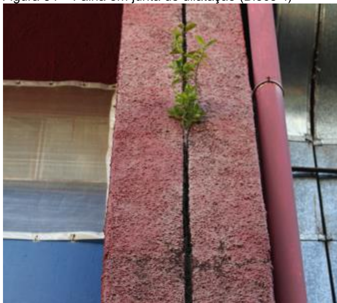
Figura 64 – Falha em junta de dilatação (Bloco 4)
