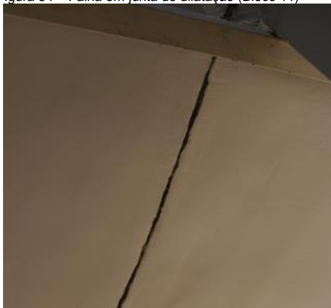
Figura 54 – Falha em junta de dilatação (Bloco 11)
