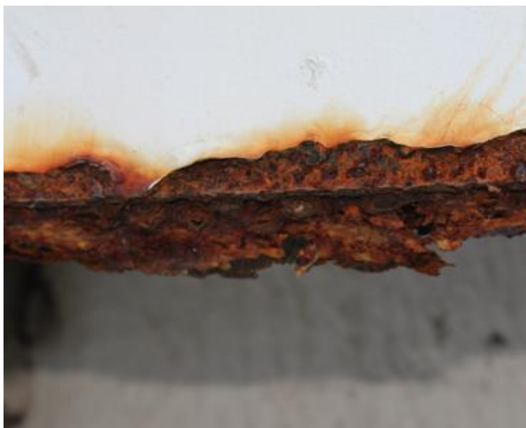
Figura 60 – Corrosão nos brises metálicos (Bloco 3)
