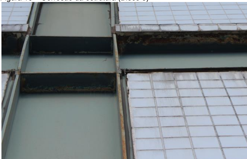
Figura 19 – Corrosão da estrutura (Bloco 9)
