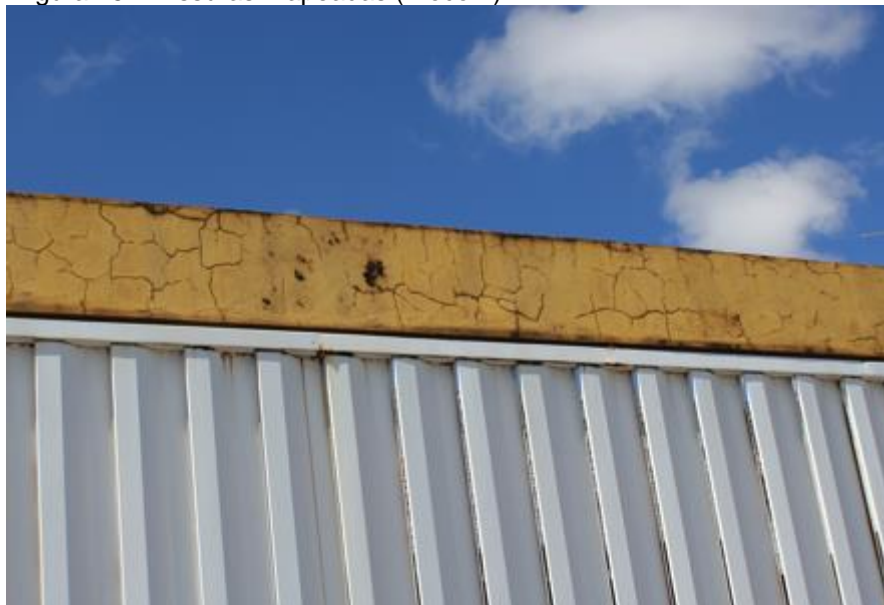
Figura 25 – Fissuras mapeadas (Bloco 1)
