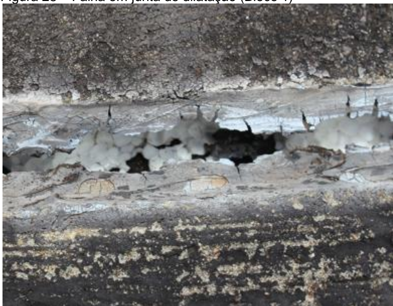
Figura 28 – Falha em junta de dilatação (Bloco 1)
