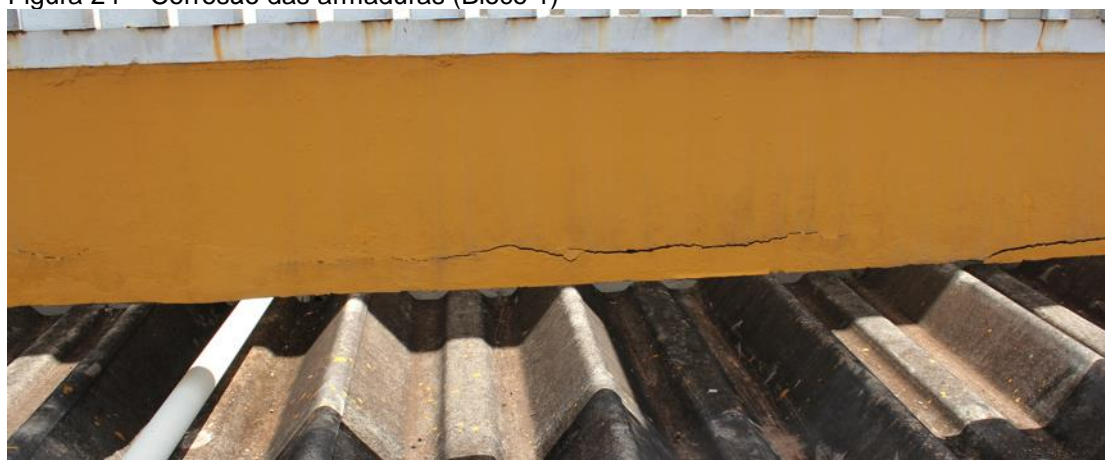
Figura 24 – Corrosão das armaduras (Bloco 1)
