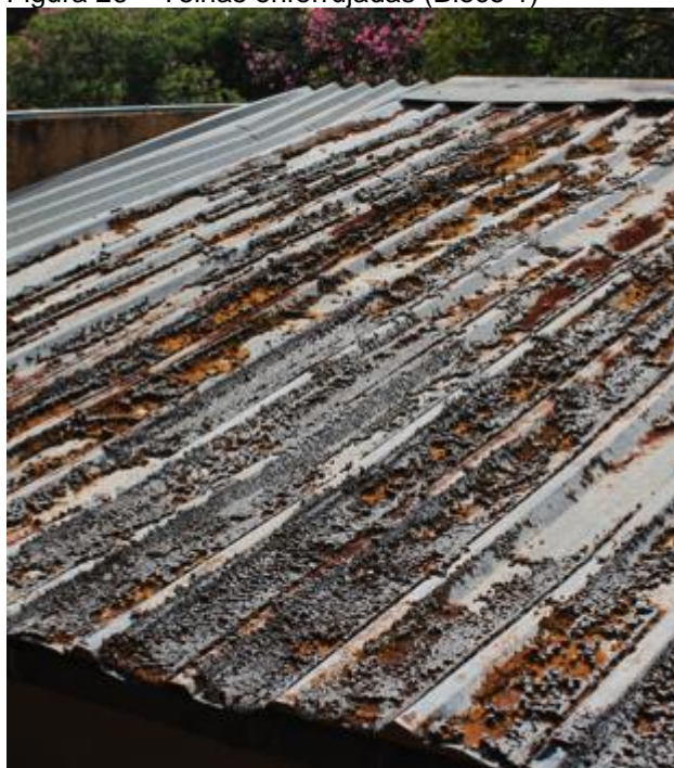
Figura 26 – Telhas enferrujadas (Bloco 1)
