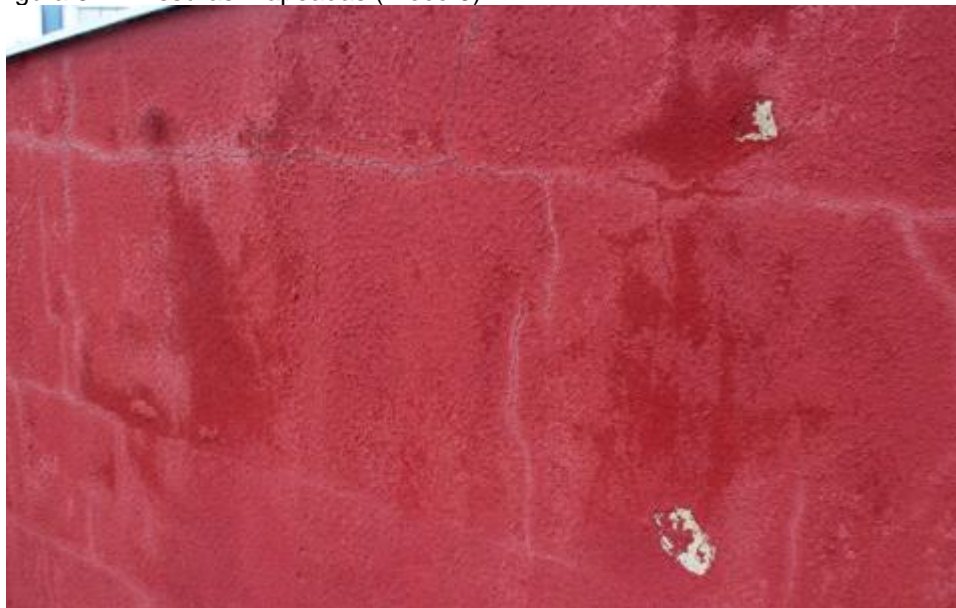
Figura 37 – Fissuras mapeadas (Bloco 9)
