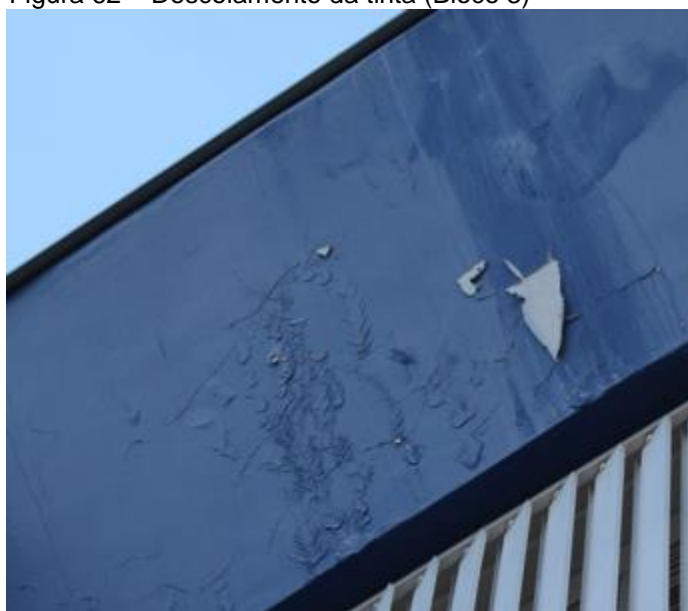
Figura 62 – Descolamento da tinta (Bloco 3)
