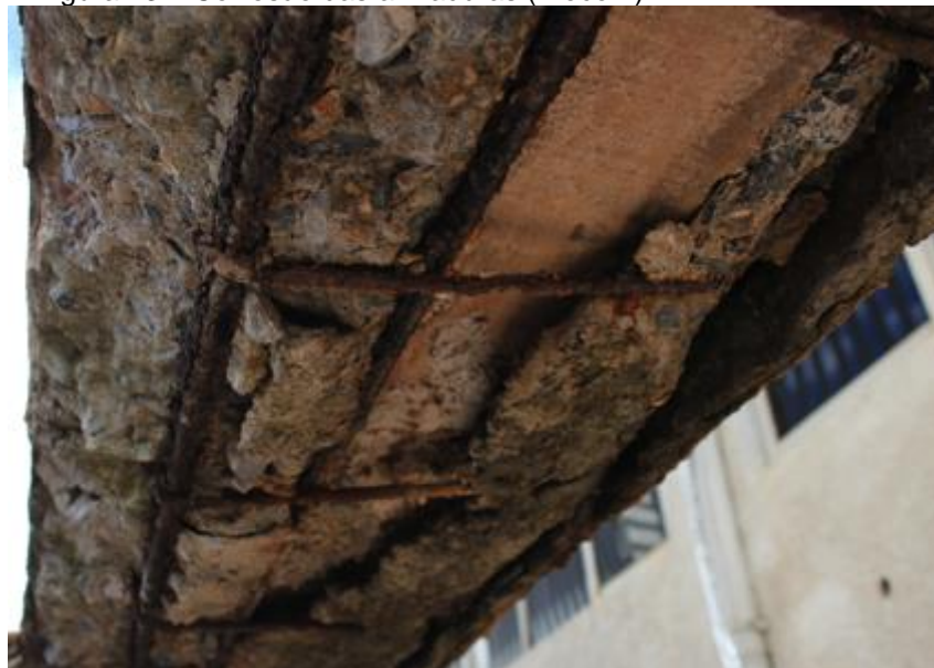
Figura 23 – Corrosão das armaduras (Bloco 1)
