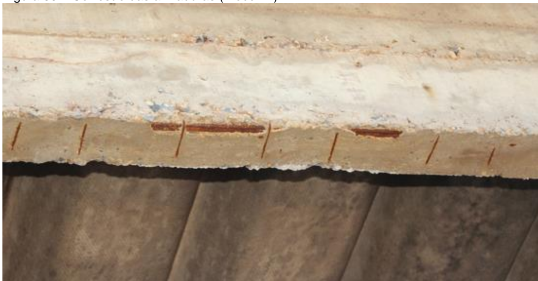
Figura 39 – Corrosão das armaduras (Bloco 11)
