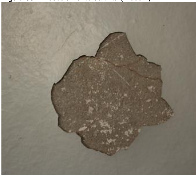
Figura 63 – Descolamento da tinta (Bloco 4)
