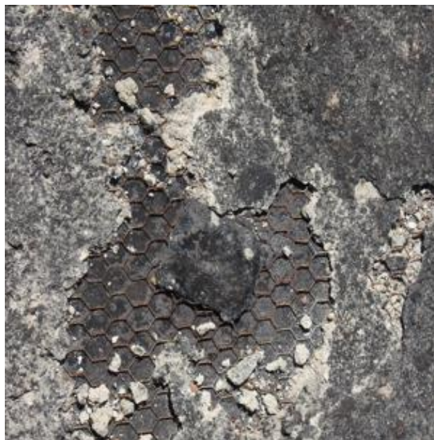
Figura 22 – Falha no sistema de impermeabilização (Bloco 1)
