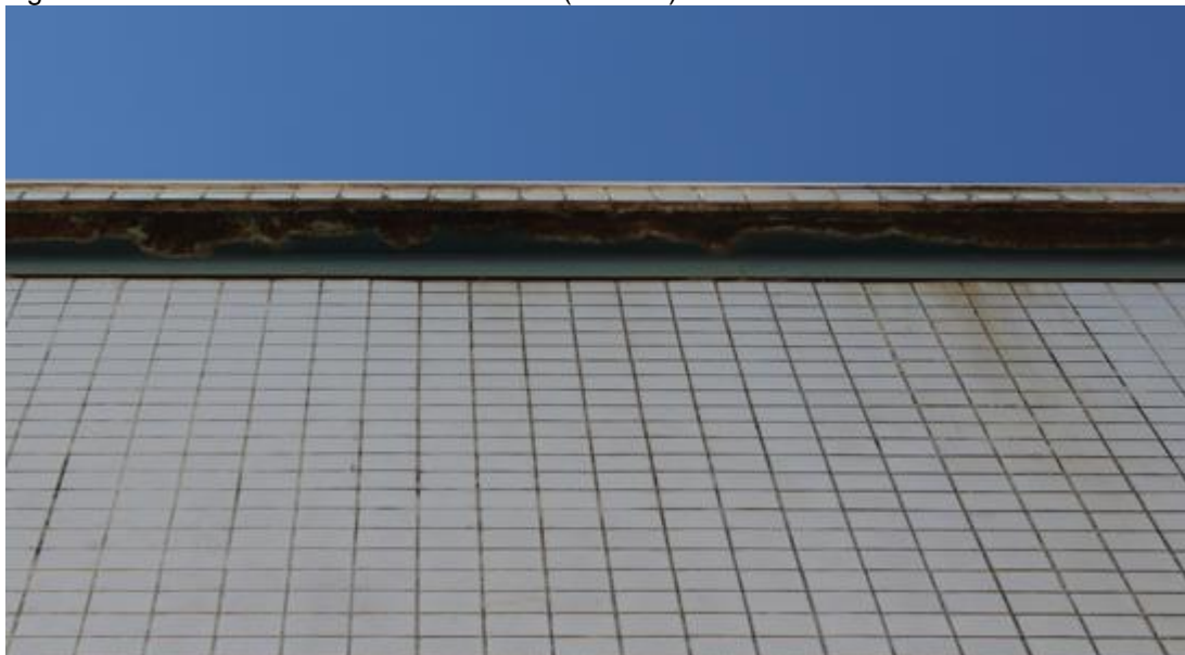
Figura 74 – Corrosão da estrutura metálica (Bloco 9)
