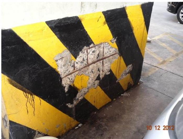
Figura 9 – Lascamentos por expansão da área de aço devido à corrosão
