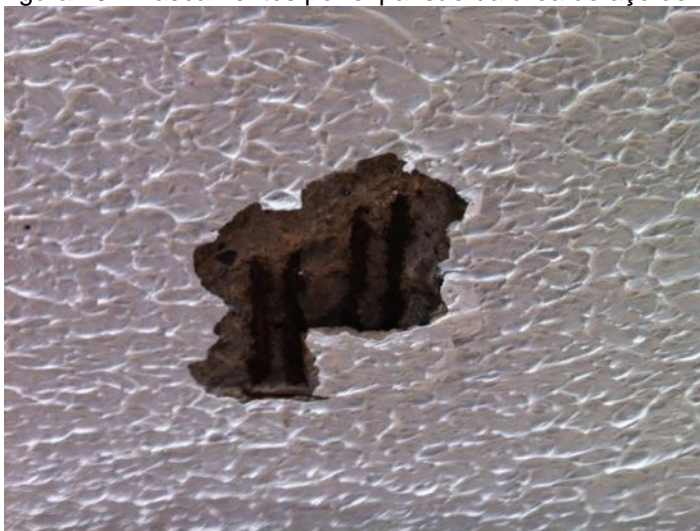
Figura 10 – Lascamentos por expansão da área de aço devido à corrosão
