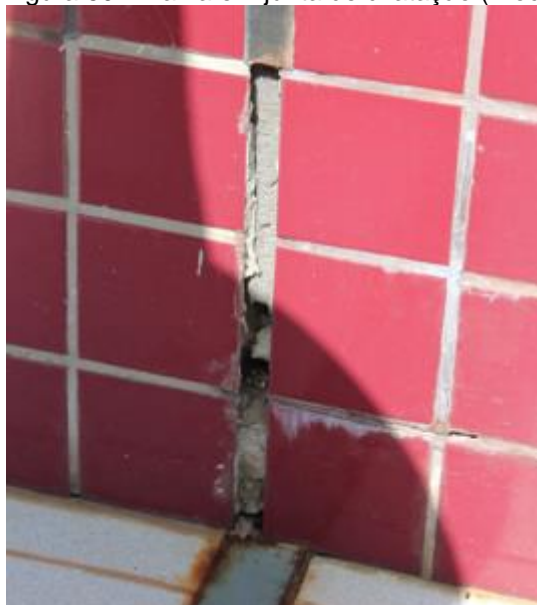
Figura 59 – Falha em junta de dilatação (Bloco 2)
