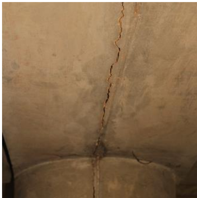
Figura 40 – Falha em junta de dilatação (Bloco 2)
