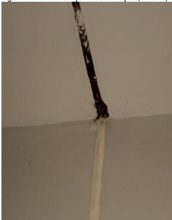
Figura 46 – Falha em junta de dilatação (Bloco 6)
