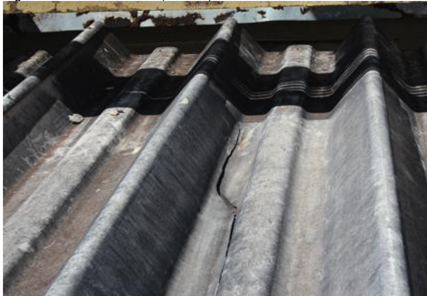
Figura 21 – Telha rachada (Bloco 1)
