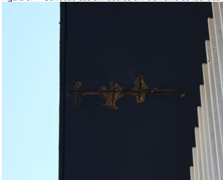
Figura 67 – Corrosão das armaduras em elemento de fachada (Bloco 6)
