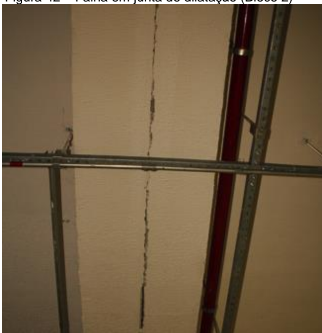
Figura 42 – Falha em junta de dilatação (Bloco 2)
