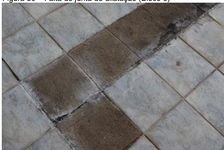
Figura 50 – Falta de junta de dilatação (Bloco 9)
