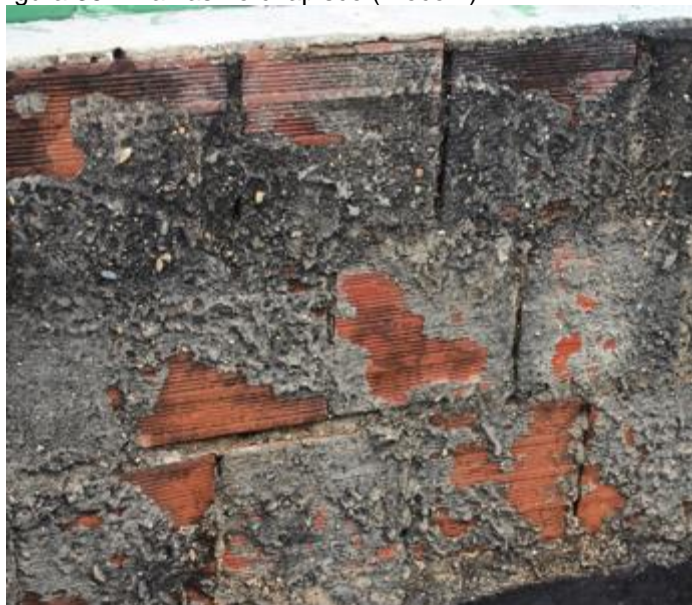
Figura 35 – Falhas no chapisco (Bloco 7)
