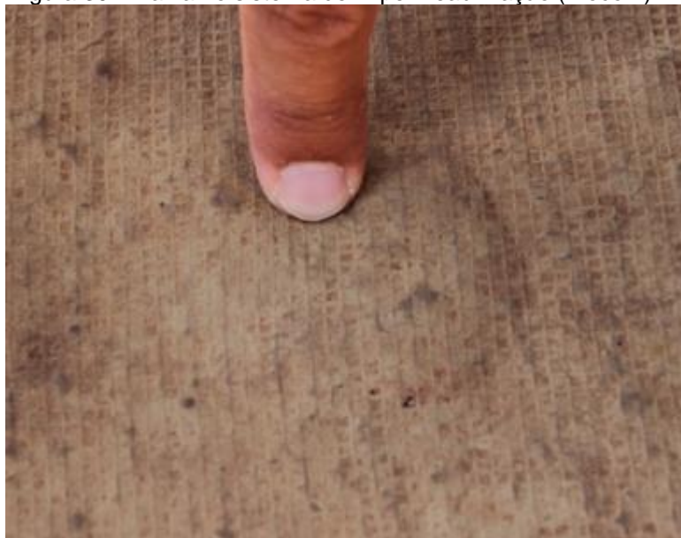
Figura 30 – Falha no sistema de impermeabilização (Bloco 2)
