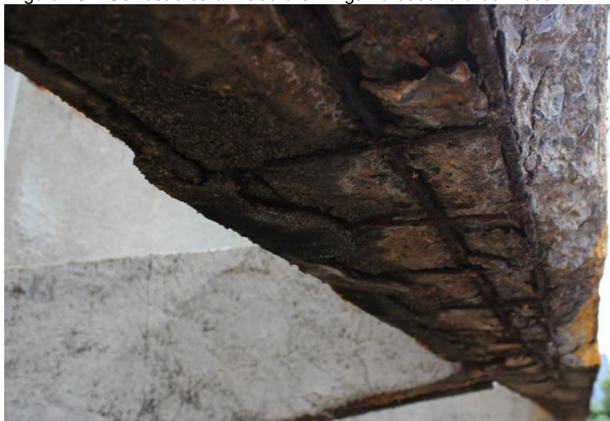
Figura 16 – Corrosão da armadura em viga na cobertura do Bloco 1
