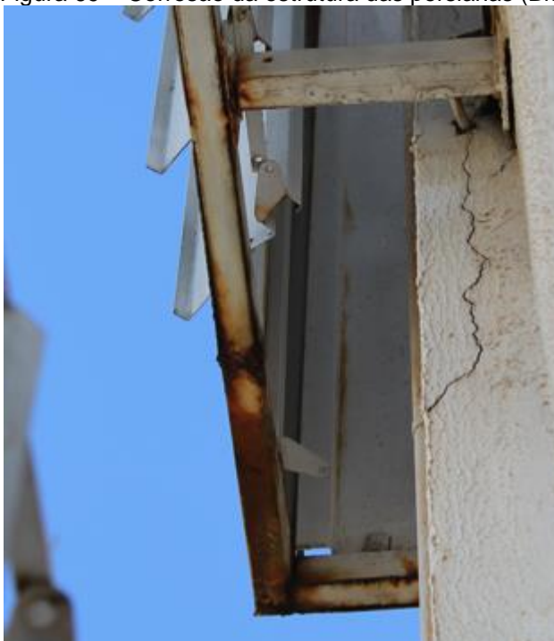
Figura 69 – Corrosão da estrutura das persianas (Bloco 7)
