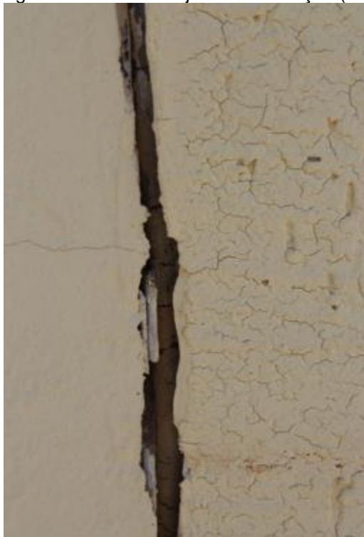
Figura 77 – Falha em junta de dilatação (Bloco 11)
