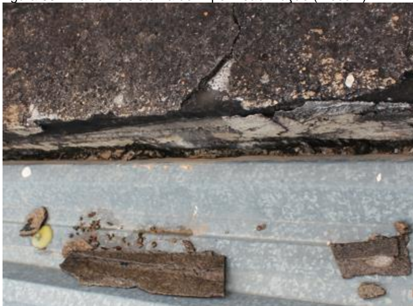
Figura 33 – Falha no sistema de impermeabilização (Bloco 4)
