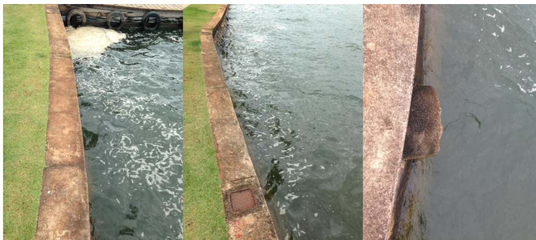
Figura 5.9 – Ponto com características de lançamento de esgoto doméstico
